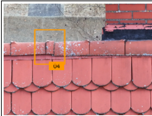
# 04 pęknięta dachówka Istotność: 3
